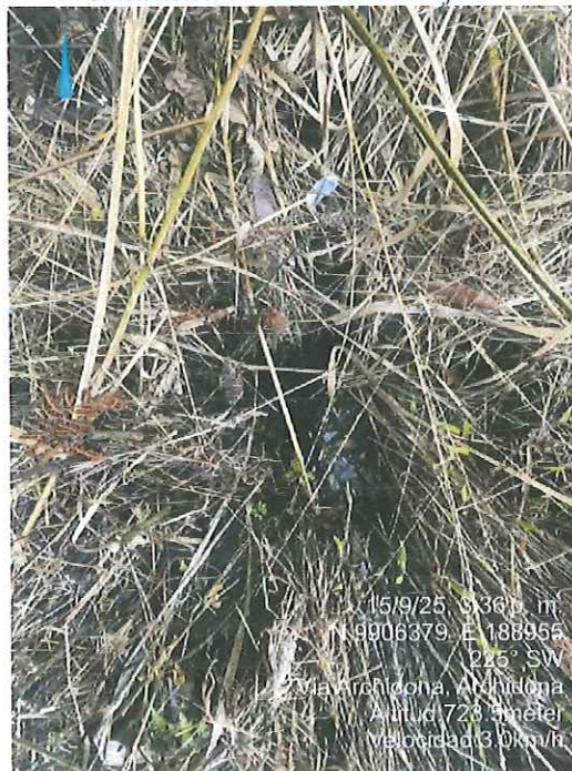
Ilustración 3: Sumidero sin rejilla.
